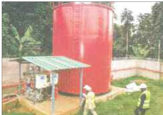
Une vue du centre emplisseur d'Afanoyoa 4.
